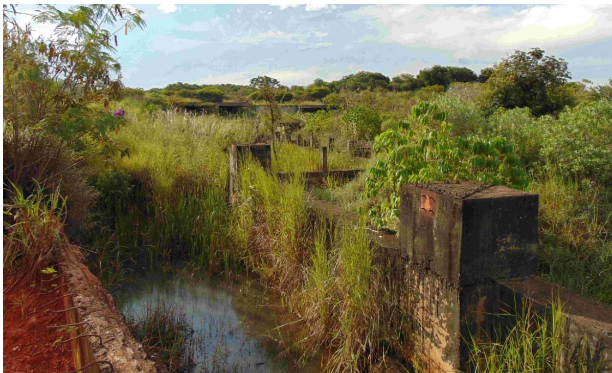
Figura 17 – Ruínas da ESG. Fonte: autor, 2014.
