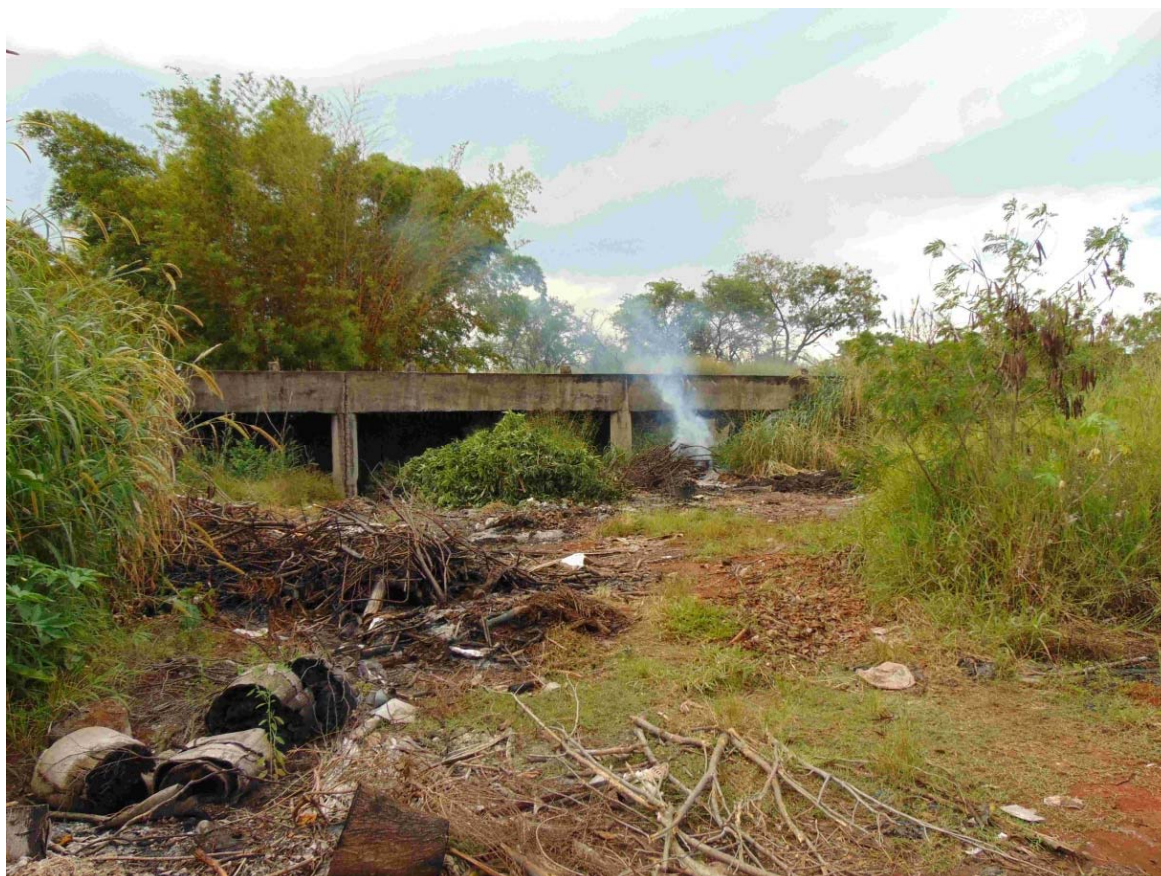
Figura 18 – Ruínas da ESG. Fonte: autor, 2014
